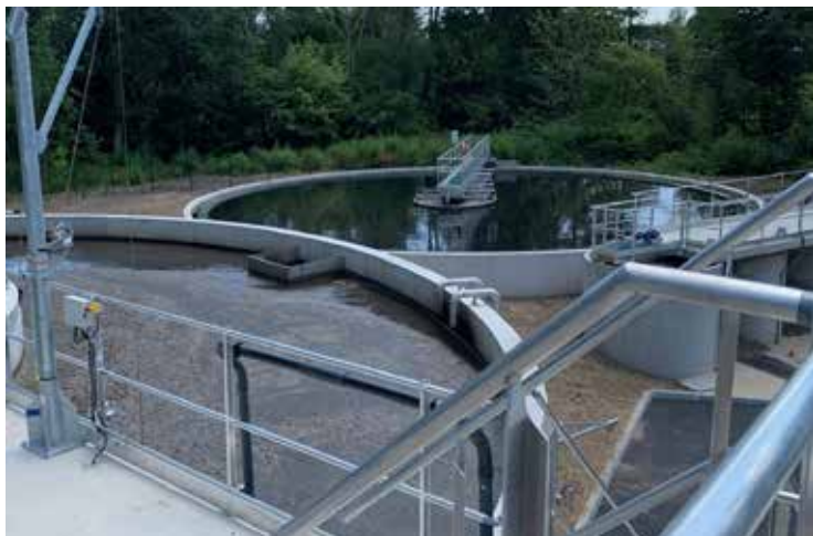
Nouvelle station d'épuration de Lailly-Dry, inaugurée en septembre 2020
